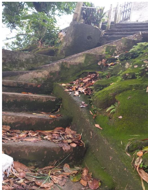
Figura 5 – Escada irregular no território do Monte Serrat
